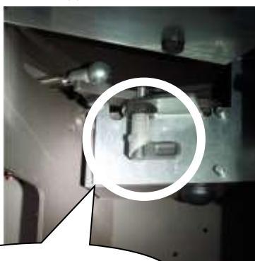
дверь остановлена для обслуживания
